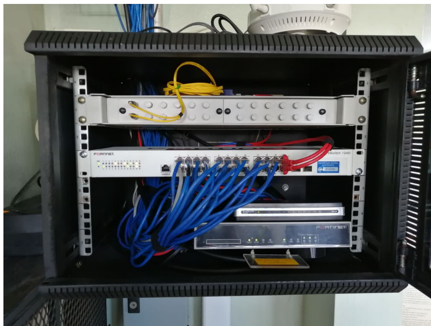
Figura #7. Gabinete de Comunicaciones Guápiles.
