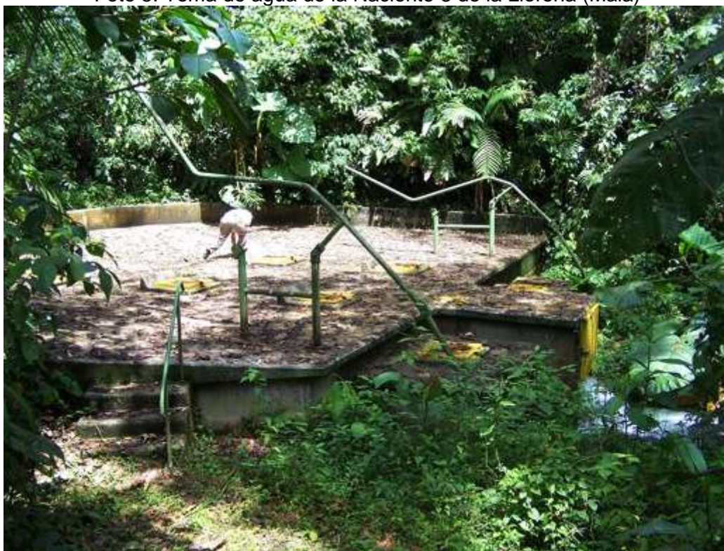
Foto 6. Infraestructura de captación en la naciente San Miguel (Muy Buena)
