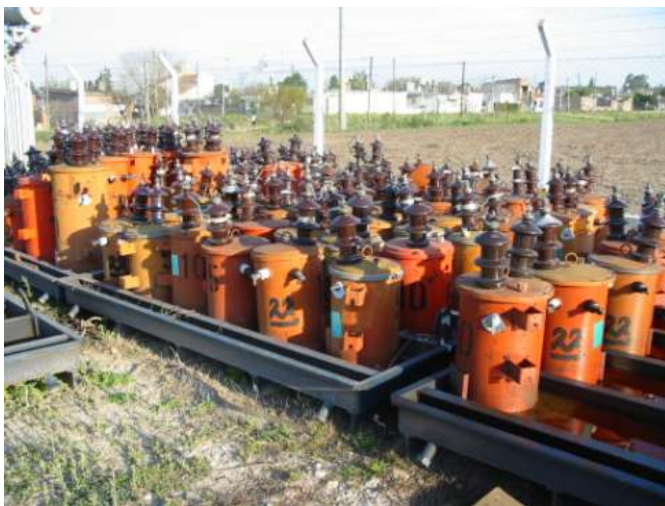
Figura 16 Transformadores con derrame confinado Bandejas metálicas con transformadores dañados. EDEERSA Argentina Fotografía Fenoglio J L, 2006.
